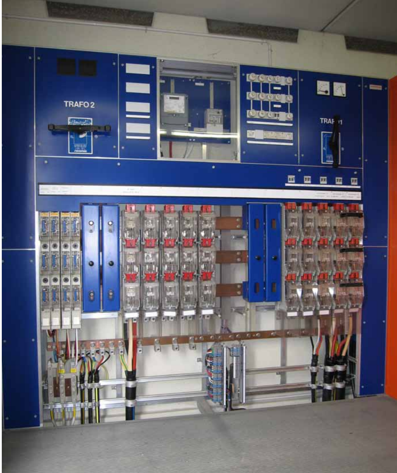
Die Trafostation Bornweg mit be- rührungssicheren Anlageteilen
