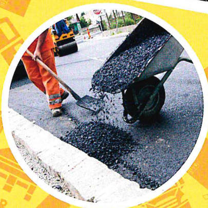
BETON / ASPHALT HERSTELLUNG
